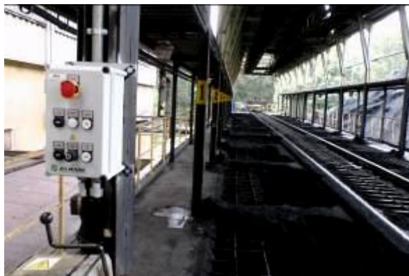
Vykládka vagonů s ovládací skříňkou
