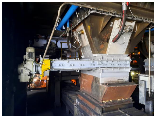
Instalace v provozu 2
