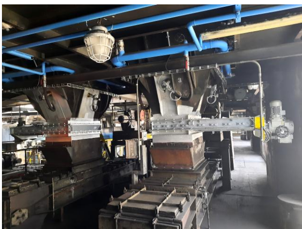
Instalace v provozu 1
