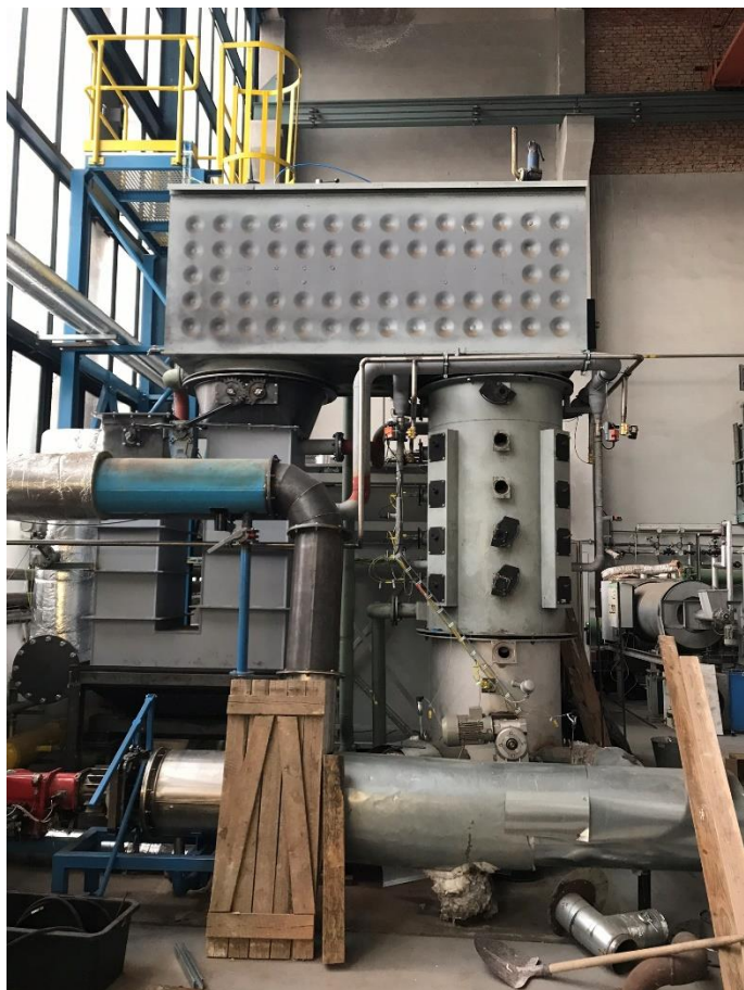
Pohled na kotel
